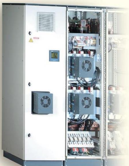
Estrutura do sistema com módulo de manobra para 01 grupo
